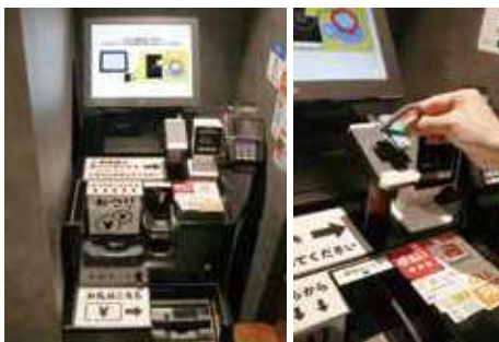
2階エントランスに設置された自動精算機。利用客は退出時にリストバンドで利用料金を精算する
